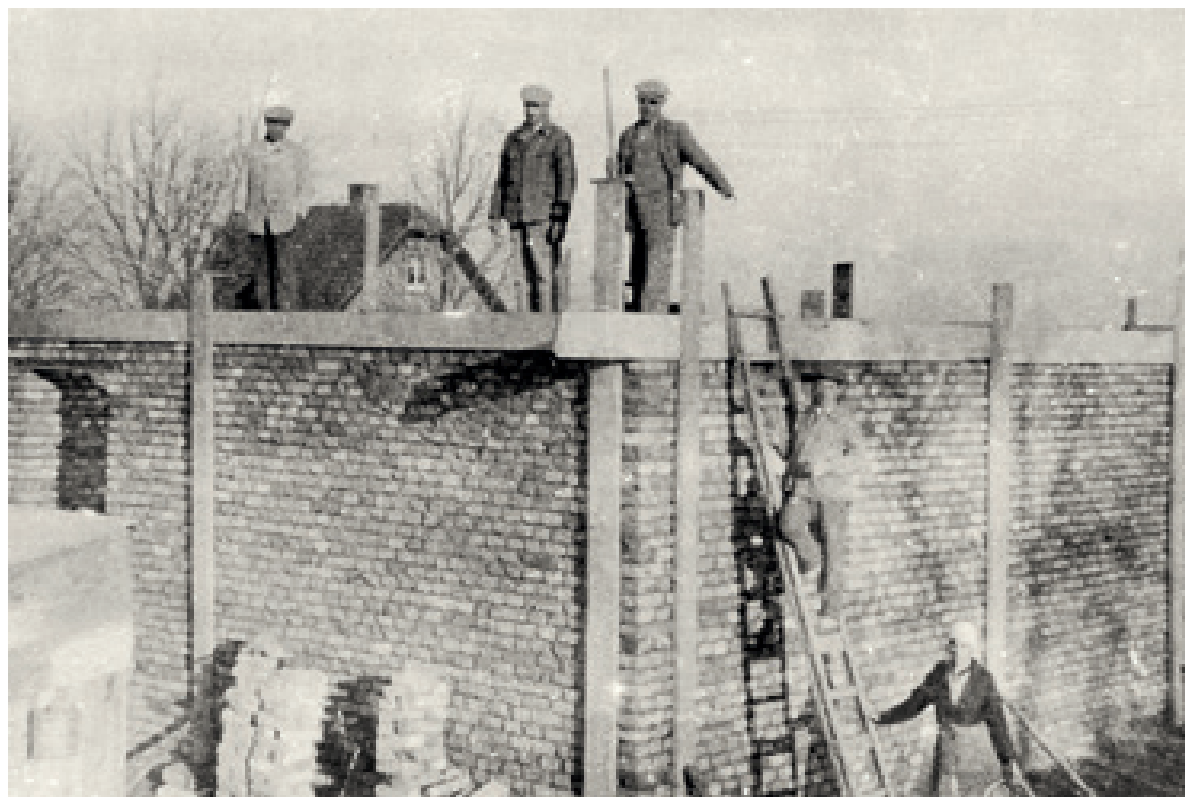
SV Hennersdorf, NÖ, 1932: Bau des Einfamilienhauses der Familie Juricek. Das mühsam erbaute Haus wurde bei einem Bombenangriff auf Hennersdorf am 24. Mai 1944 durch einen Volltreffer vollständig zerstört.
